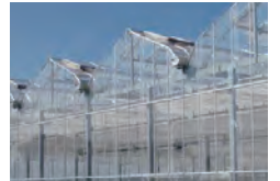
換気設備 片側全面天窗
