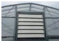
換気設備 換気扇・シャッター付
