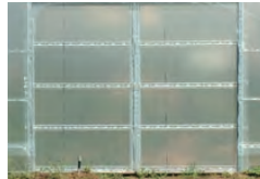
換気設備 出入口引分戸(スチール製)
