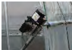
換気設備 谷換気・自動巻上
