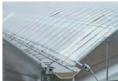
換気設備 谷換気
