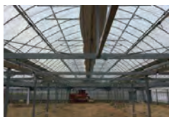
内張カーテン 谷引カーテン
