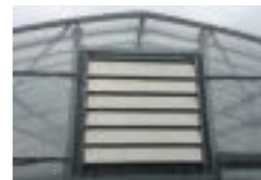
換気設備 換気扇・シャッター付
