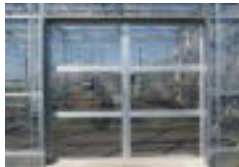
換気設備 アルミ引分戸
