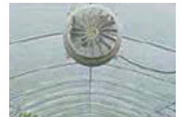
換気設備 循環扇
