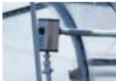
換気設備 谷換気・手動巻上
