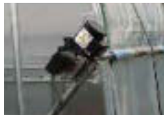
換気設備 谷換気・自動巻上
