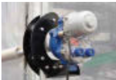
換気設備 側面換気・自動巻上
