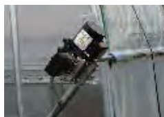
換気設備 谷換気・自動巻上
