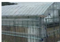
換気設備 側面2段巻上(手動)
