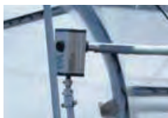
換気設備 谷換気・手動巻上
