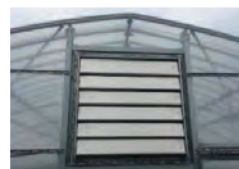
換気設備 換気扇・シャッター付
