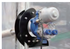
換気設備 側面換気・自動巻上
