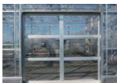
換気設備 アルミ引分戸
